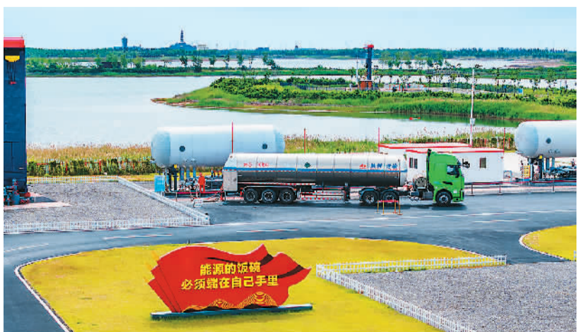
中国石化胜利油田建成了国内首个百万吨级CCUS(碳捕集、利用与封存)项目——齐鲁石化—胜利油田CCUS项目，该项目每年可减排二氧化碳100万吨。图为胜利油田某113区块二氧化碳1站，车辆将液态二氧化碳导入储气罐，并经注气井注入到油层，实现“封碳”“增油”双赢。 赵树宴摄
