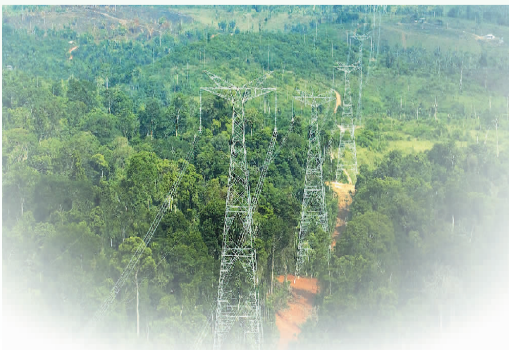
美丽山一期项目输电线路。 本版图片均为国网巴控公司供图
