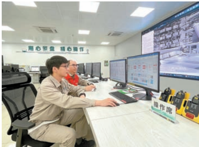
◆ 閩粵聯網公司雲霄換流站運維人員加強首次滿功率運行時的重要信號監盤。香港文匯報廣東傳真
