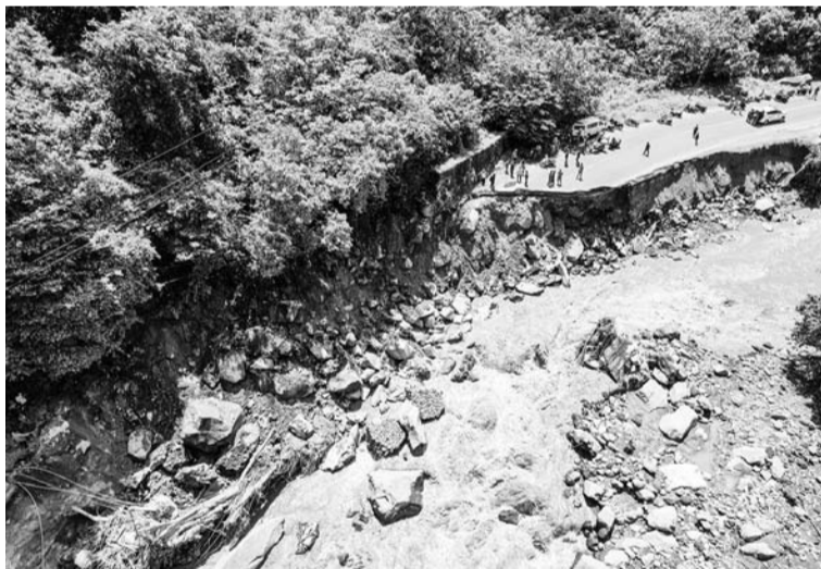
巴东-武吉丁宜公路因洪灾中断 根据5月12日接获的消息，由于前一天遭洪水冲击的缘故，经过巴东班让(Padangpanjang)的巴东(Padang)-武吉丁宜(Bukittinggi)主干线中断，汽车只好转移到其它道路前行。
