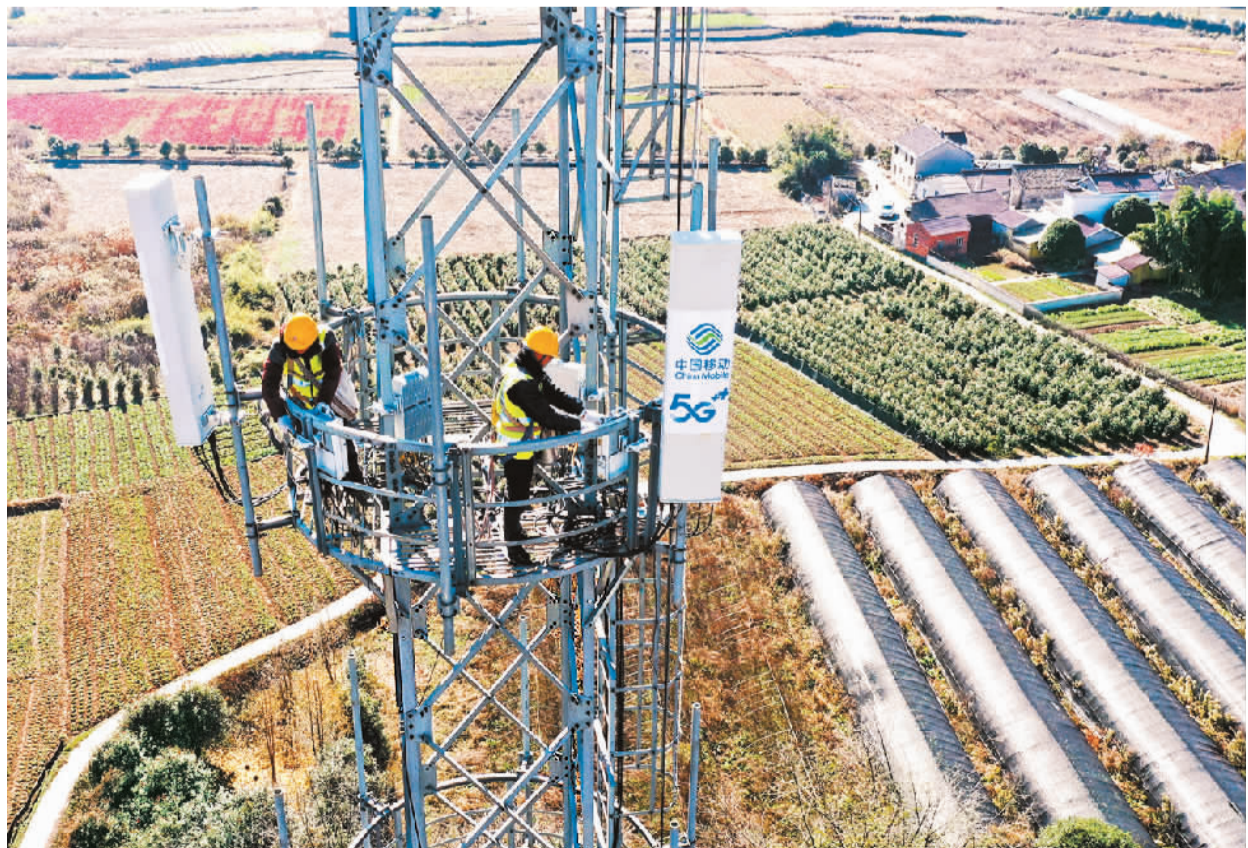
▲在安徽省铜陵市义安区钟鸣镇，安徽移动铜陵分公司技术人员在进行5G基站设备更新升级。
