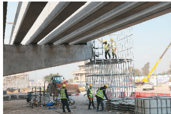
伊拉克巴格达尼苏尔立体交通枢纽项目施工现场。 哈利勒·达伍德摄（新华社发）
