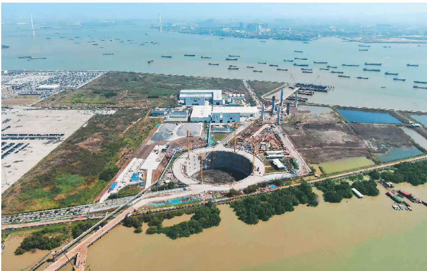
连日来，广东省交通集团投资建设的狮子洋通道工程稳步推进。该项目是继港珠澳大桥、深中通道后，粤港澳大湾区又一超级工程。项目为东西走向多层复合公路通道，其控制性工程狮子洋大桥采用主跨2180米、双层钢桁悬索桥“一跨过江”，计划2028年建成通车。图为狮子洋大桥西锚碇及远处的西主塔承台施工现场。新华社记者 邓华摄
