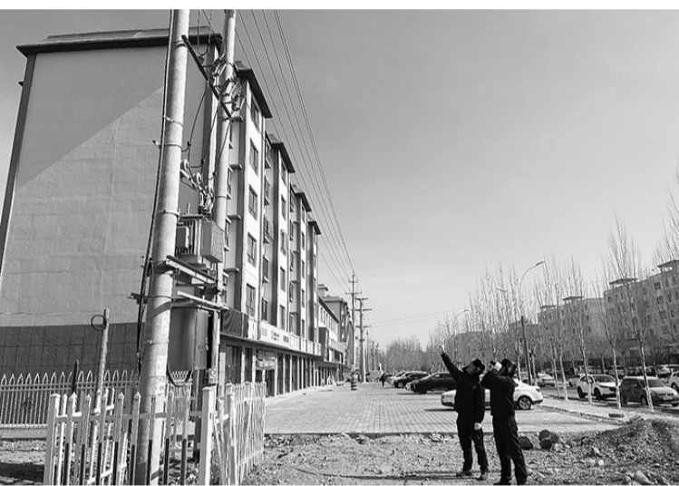
据国网阿合奇县供电公司介绍,当地主电网和配电网运行正常。目前,当地列车运行暂未受到影响。 新华社发(满肃儿 摄)
