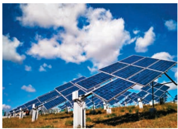
◆香港應積極與內地合作開發更多樣化的綠色金融產品。圖為內地光伏發電場。
