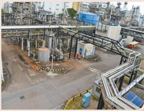
煤氣公司的聯廠熱能轉移設置。
