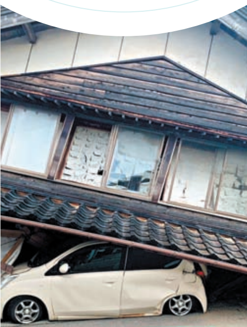
◆有汽車被倒塌房屋壓住。路透社
