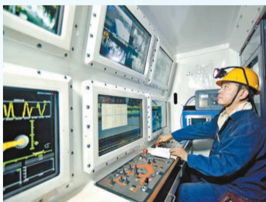
位於800米井下的十礦集中控制中心
