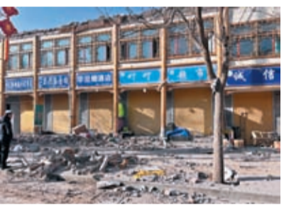
12月19日，青海省海東市循化撒拉族自治縣白莊鎮，沿街舖面受損嚴重。
