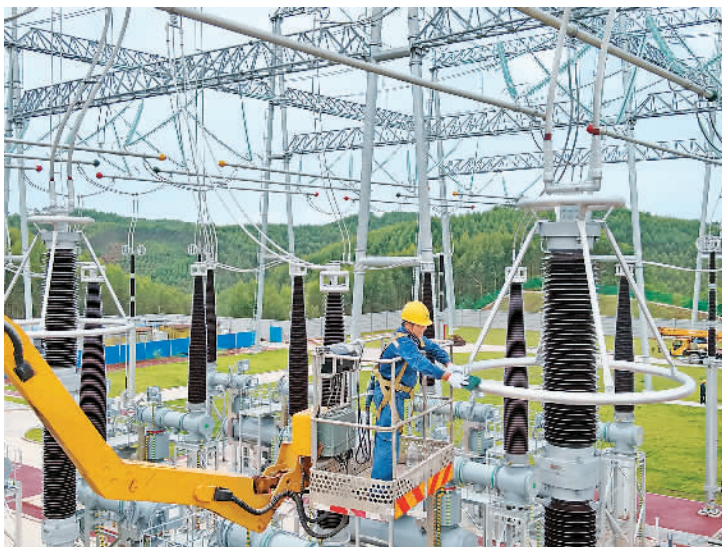
日前，广西电网技术人员在对南宁市新江镇500千伏新江变电站设备进行投运前检查。
