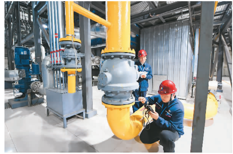
近日北方连续降温,为确保市民温暖过冬,北京市已于11月6日0时点火试运行,启动供暖。11月7日0时正式达标供暖。图为11月6日,北京市热力集团有限责任公司海淀分公司技术人员在巡查燃气供热设备。 新华社记者 鞠焕宗摄
