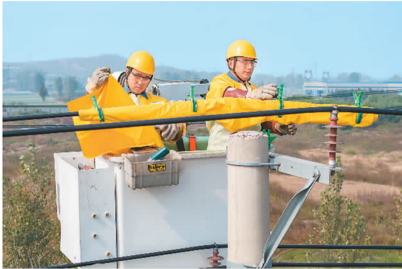
随着今年迎峰度冬时段到来，国网山东省兰陵县供电公司组织电力工作人员到辖区开展电网秋检工作，对老旧设备进行检修消缺、升级改造，确保电网平稳运行和供电安全可靠。图为电力工作人员正对供电设备进行检修。宋国庆摄（人民视觉）
