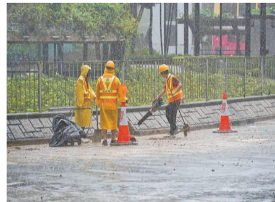
工人在環翠邨抽走積水。
