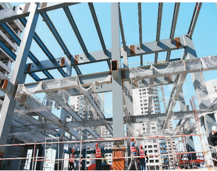
国庆假期期间，在位于中国（山东）自由贸易试验区青岛片区的航运贸易金融融合创新基地项目上，600多名建设者坚守一线，抢抓施工黄金期，奋力冲刺项目建设关键节点。据介绍，该项目总建筑面积约200万平方米，建成后借助青岛沿海口岸优势，将成为北方航运贸易金融总部聚集平台。图为建设者在项目工地上进行钢结构安装。新华社记者 李紫恒摄
