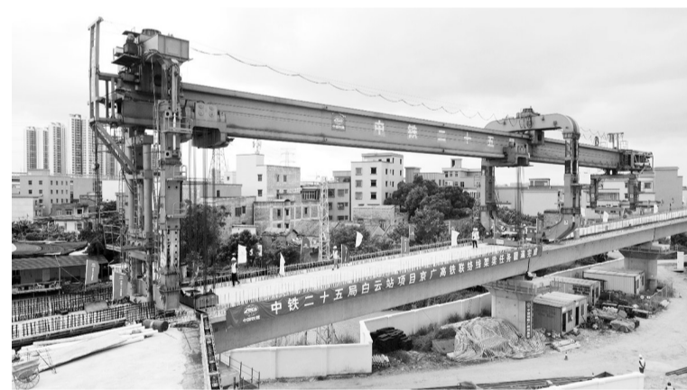
9 月 6 日,广东省广州市,广州白云站枢纽京广高铁联络线最后一榀箱梁完成架设。李佳珊 摄
