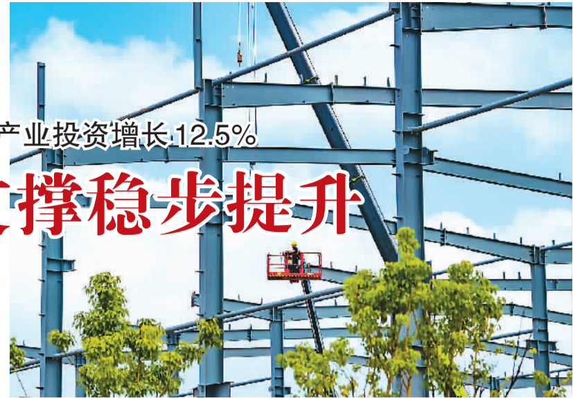
江西省赣州市赣县区稀金谷智能装备制造产业园项目是该区重点项目，总投资逾5.7亿元。图为7月17日，建设者在项目现场进行施工作业。胡江涛摄（人民视觉）
