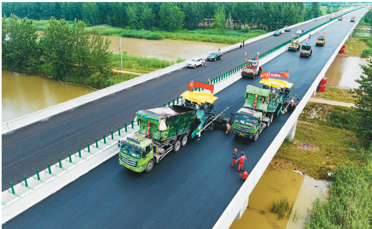
七月六日，位于江苏省宿迁市沭阳县内的宿连高速公路工程建设现场，施工人员进行摊铺沥青作业，全力推进项目进度。（周永摄（人民视觉））
