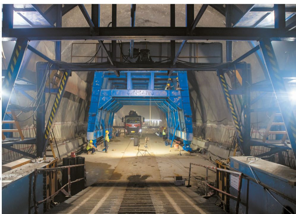
施工人員在廣澳港區鐵路汕頭海灣隧道裏冒着高溫施工。陳史攝
