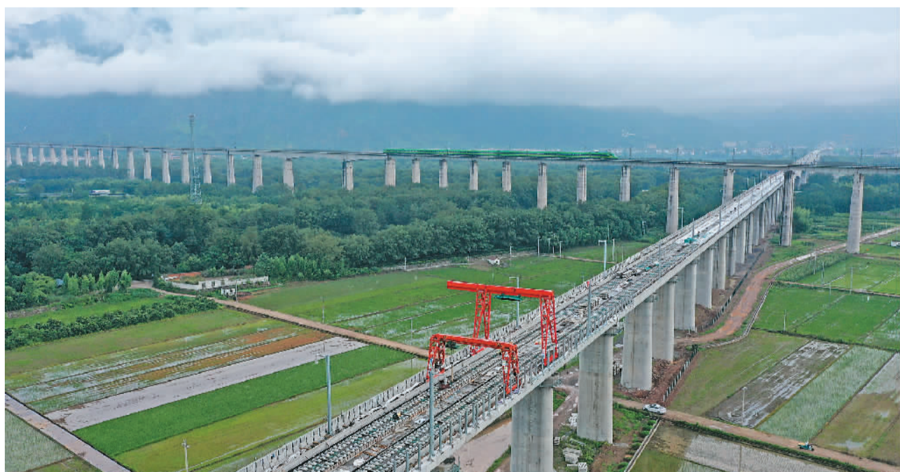
6月22日,在浙江省台州市的杭甬铁路仙居特大桥施工现场,铁路建设者正抓紧施工,确保项目按期完工。杭甬铁路全长331公里,设计时速350公里,是浙江省“1小时交通圈”的重要组成部分,是长三角经济区连接海峡两岸经济区的便捷通道,也是连接长江经济带和海上丝绸之路的重要战略通道。图为工人们在无砟轨道施工。 王华斌摄(人民视觉)
