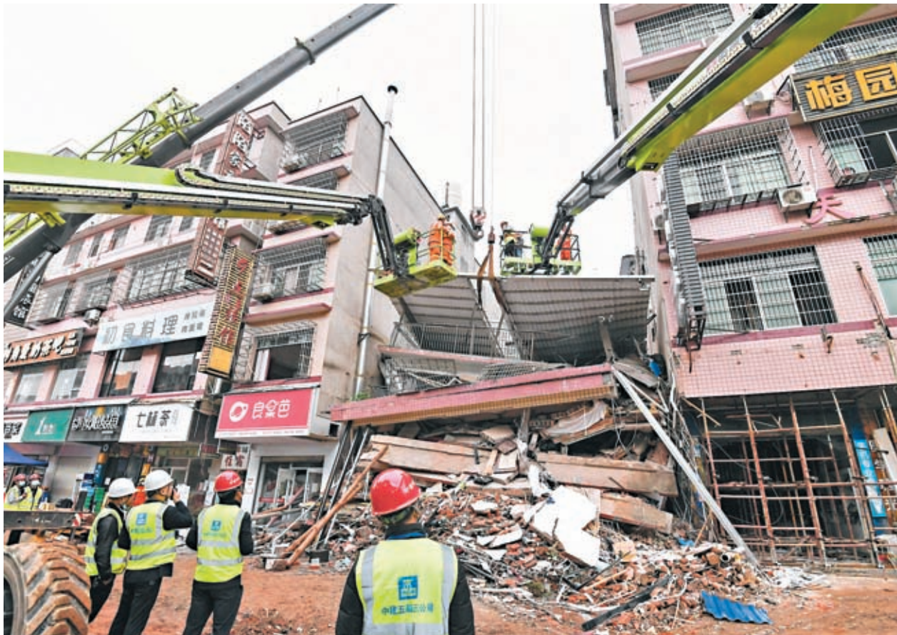
◆2022年5月1日，救援人員在湖南長沙居民自建房倒塌事故現場進行救援。
