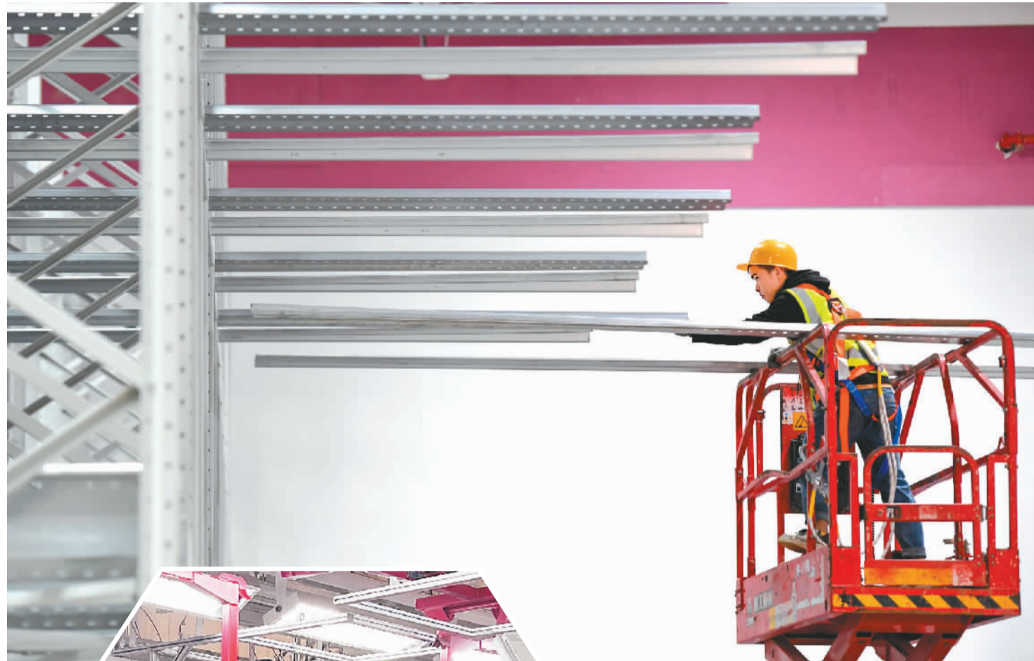
▲江西省丰城市法国独资企业佛吉亚歌乐电子(丰城)有限公司的工作人员在新厂房内安装汽车电子产品总装生产线设备。周亮摄(人民视觉)
