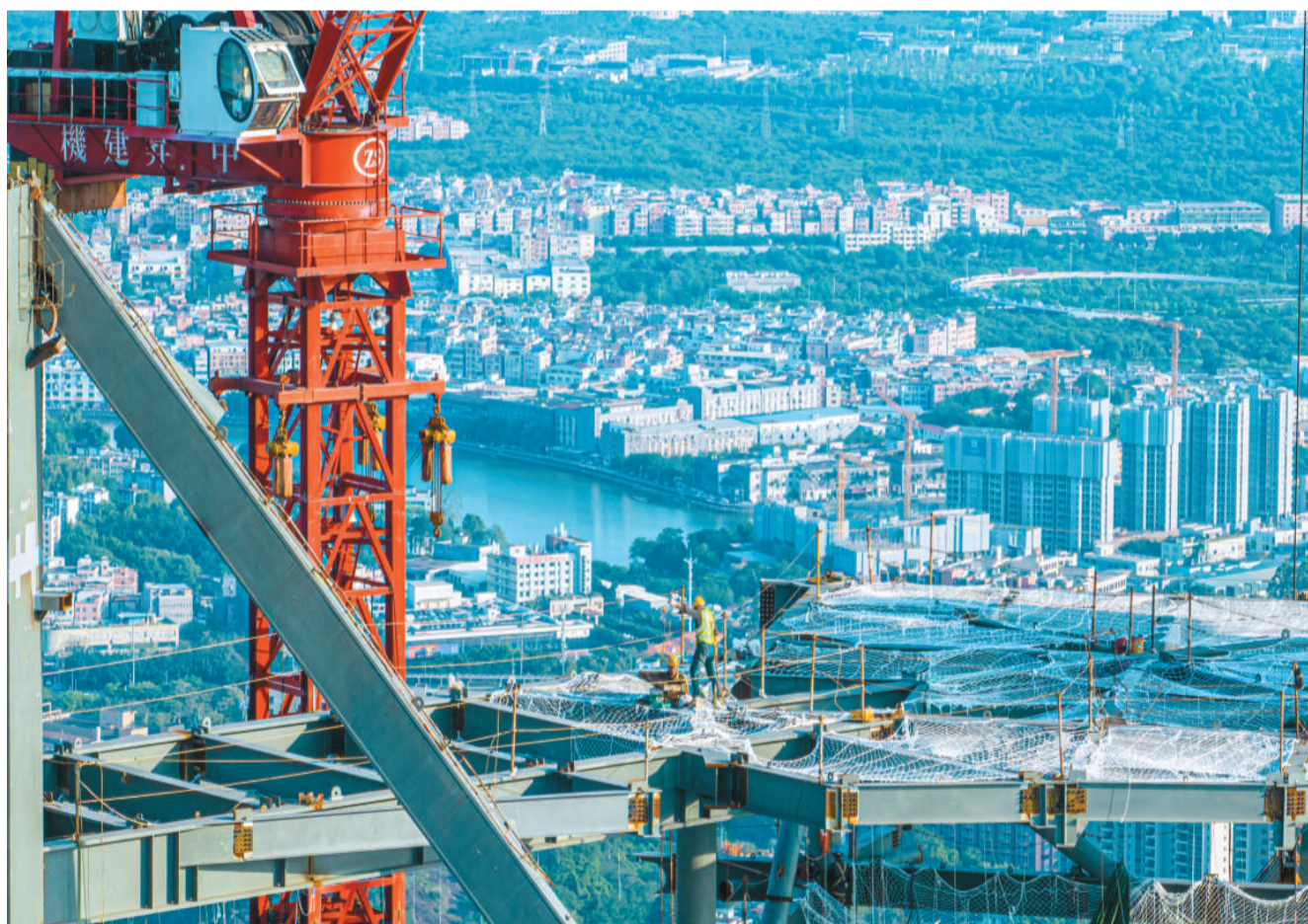
近日，广东省广州市琶洲人工智能与数字经济试验区吊塔林立，建设者正在加紧施工，现场忙碌有序。
