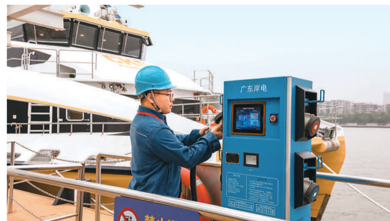
广东省广州市琶洲港澳客运口岸往返香港国际机场航线近日开始试运营。旅客从琶洲口岸乘船，可直达香港国际机场（海天码头）。为做好保障服务，南方电网广州供电局日前投入3台岸基船舶供电系统，为穿梭的客船提供交流用电。图为广州市供电局工作人员在现场测试岸基船舶供电系统。赵仲明摄
