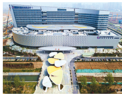
4月1日，航拍的安徽省合肥市深圳路国家儿童区域医疗中心。该基建项目即将全面竣工，目前已进入内装施工阶段。 方好摄（人民视觉）
