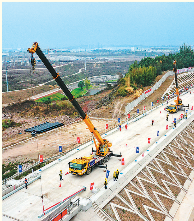
施工人员在位于重庆市永川区的渝昆高铁施工现场架设接触网杆。 新华社记者 唐奕摄
