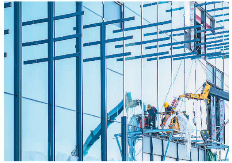
今年以来,江苏省宿迁市宿城经济开发区加快建设激光智造小镇,推动形成集激光装备设计研发、加工制造、展示销售等为一体的激光光电产业科技综合体,促进当地经济高质量发展。图为近日宿城经济开发区激光智造小镇施工现场。徐江海摄(人民视觉)
