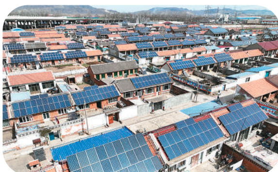
河北省玉田县孤树镇庄村户的屋顶分布式光伏面板（无人机照片）。新华社记者 牟宇摄
