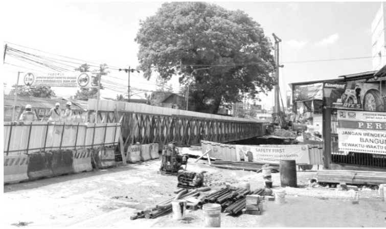
芝阿维 Cikereteg 临时用大桥 3 月 25 日, 茂物至苏甲巫眉路段的 Cikereteg 临时用大桥已不能通车。
