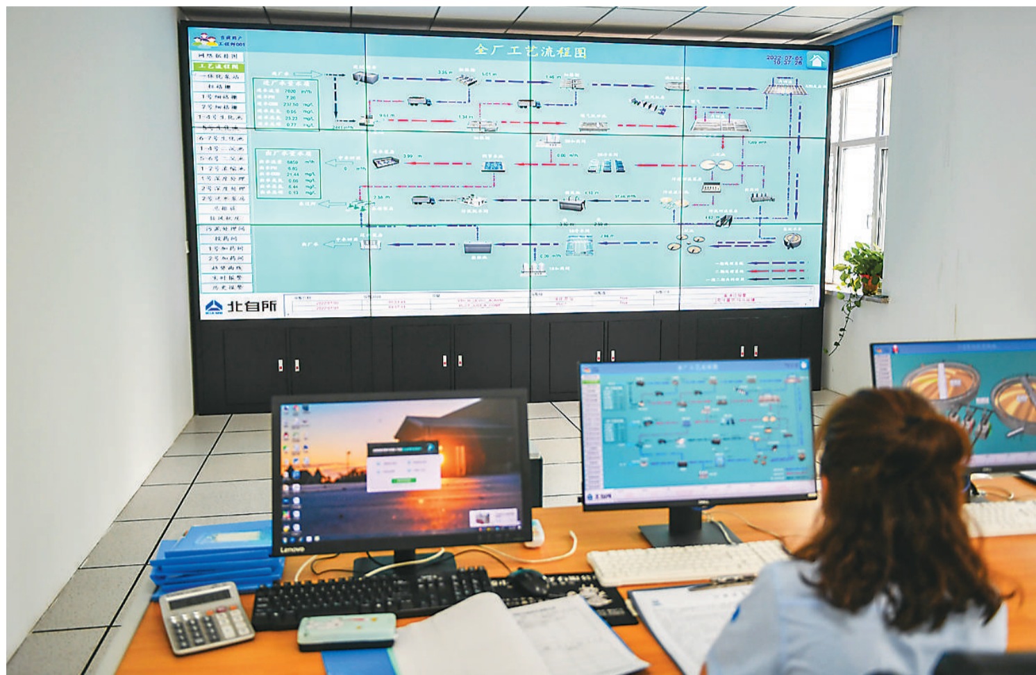
在吉林省辽源市中核辽源环保科技有限公司，工作人员借助数字科技监控污水处理设备状态。
