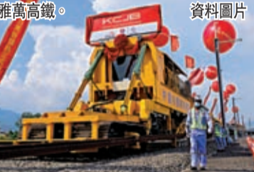
◆中方願同各國一道，推動共建「一帶一路」高質量發展。圖為中國與印尼共同建設中的雅萬高鐵。資料圖片
