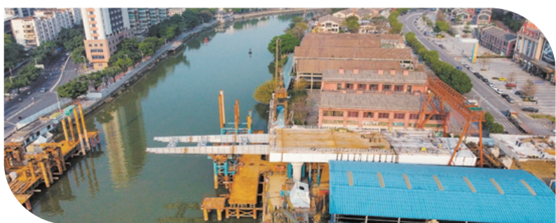
江門船廠跨江橋梁正進行主橋上部鋼箱梁及引橋現澆箱梁結構施工。
