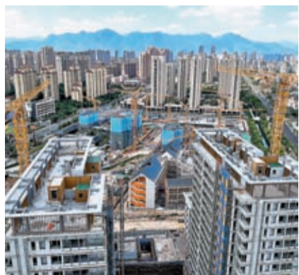
◆隨着政策扶持力度持續加碼，房地產行業出現一定復甦跡象。圖為福州一處在建樓盤。資料圖片
