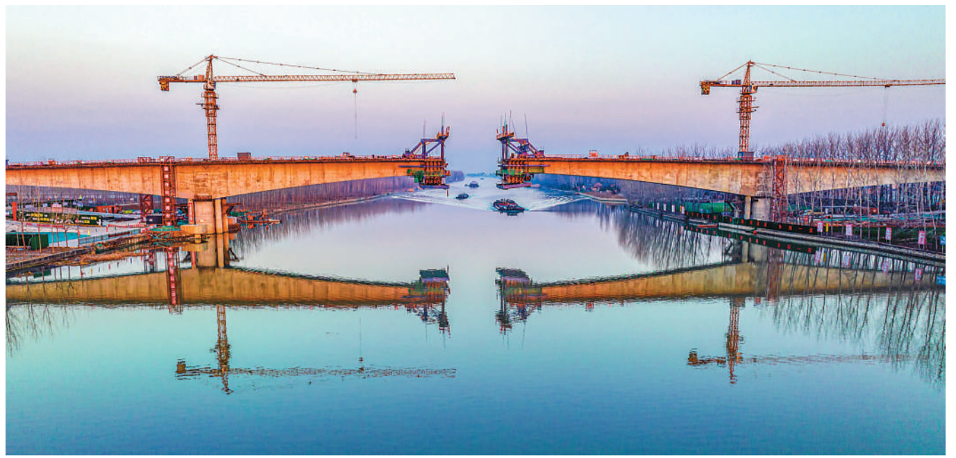
二月二十六日，江苏省宿迁市宿豫区仰化镇，京杭大运河特大桥项目施工现场。陈红摄（人民图片）
