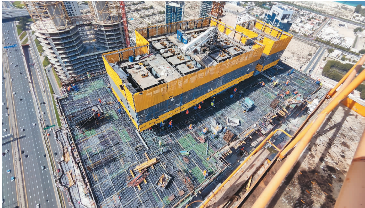
近日，由中铁十八局承建的阿联酋迪拜超高层建筑——罗塔纳高档酒店公寓项目顺利封顶。
