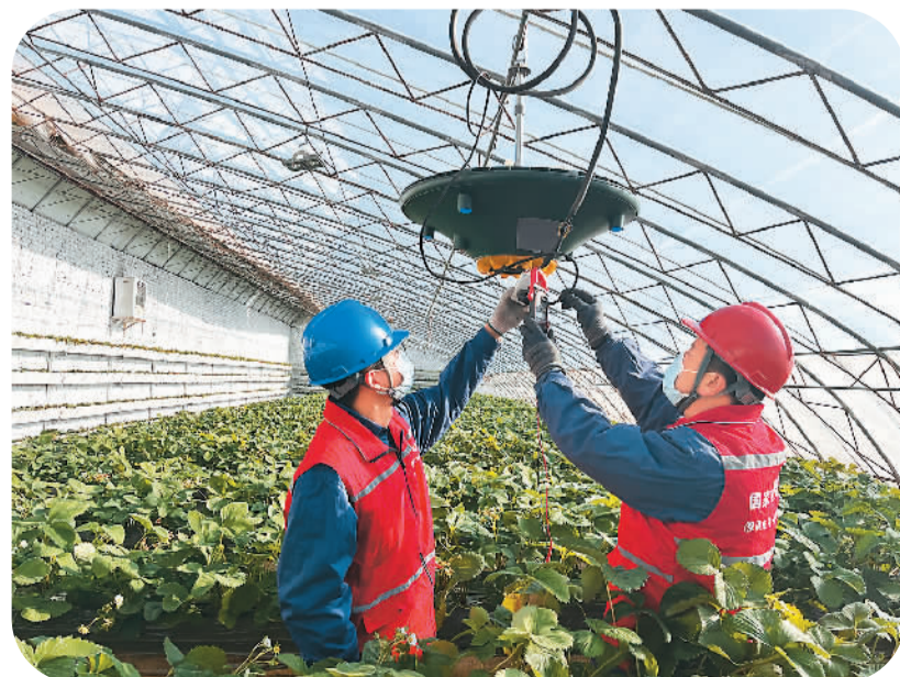
河北省保定市满城区将乡村振兴发展与地方种植特色相融合，全力保障老百姓“菜篮子”供应与安全。图为国网保定市满城区供电公司员工对果蔬种植大棚用电设备进行走访巡查。高航政摄
