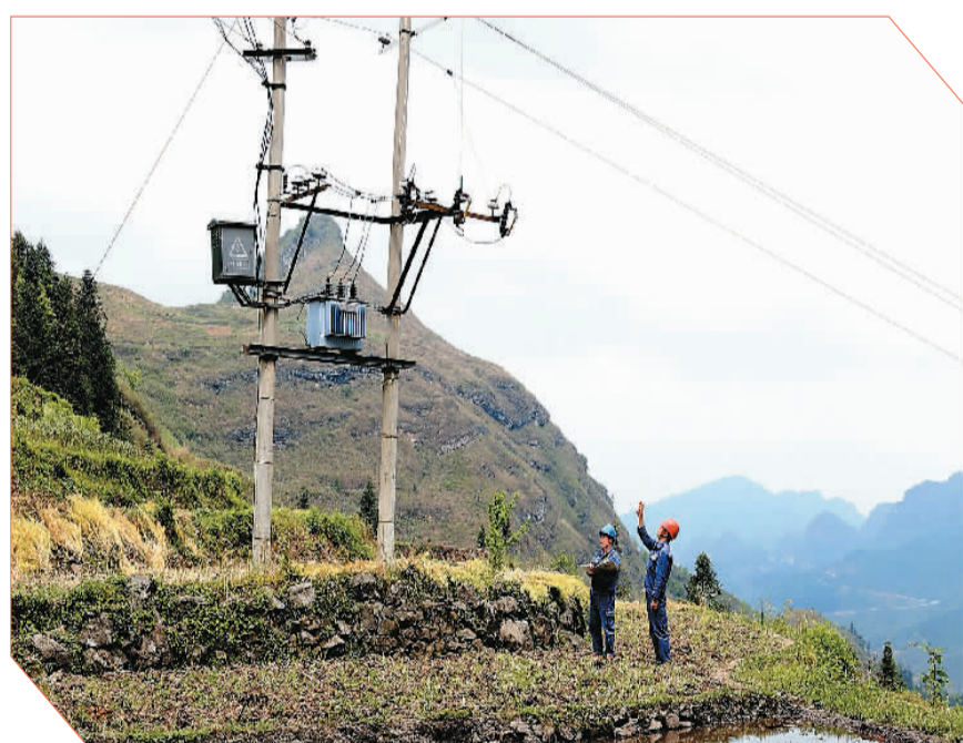
▲ 2月1日,为保障春耕用电,在贵州省黔东南苗族侗族自治州,南方电网贵州兴义晴隆供电局工作人员走进田间巡检,确保配电设备安全稳定运行。
