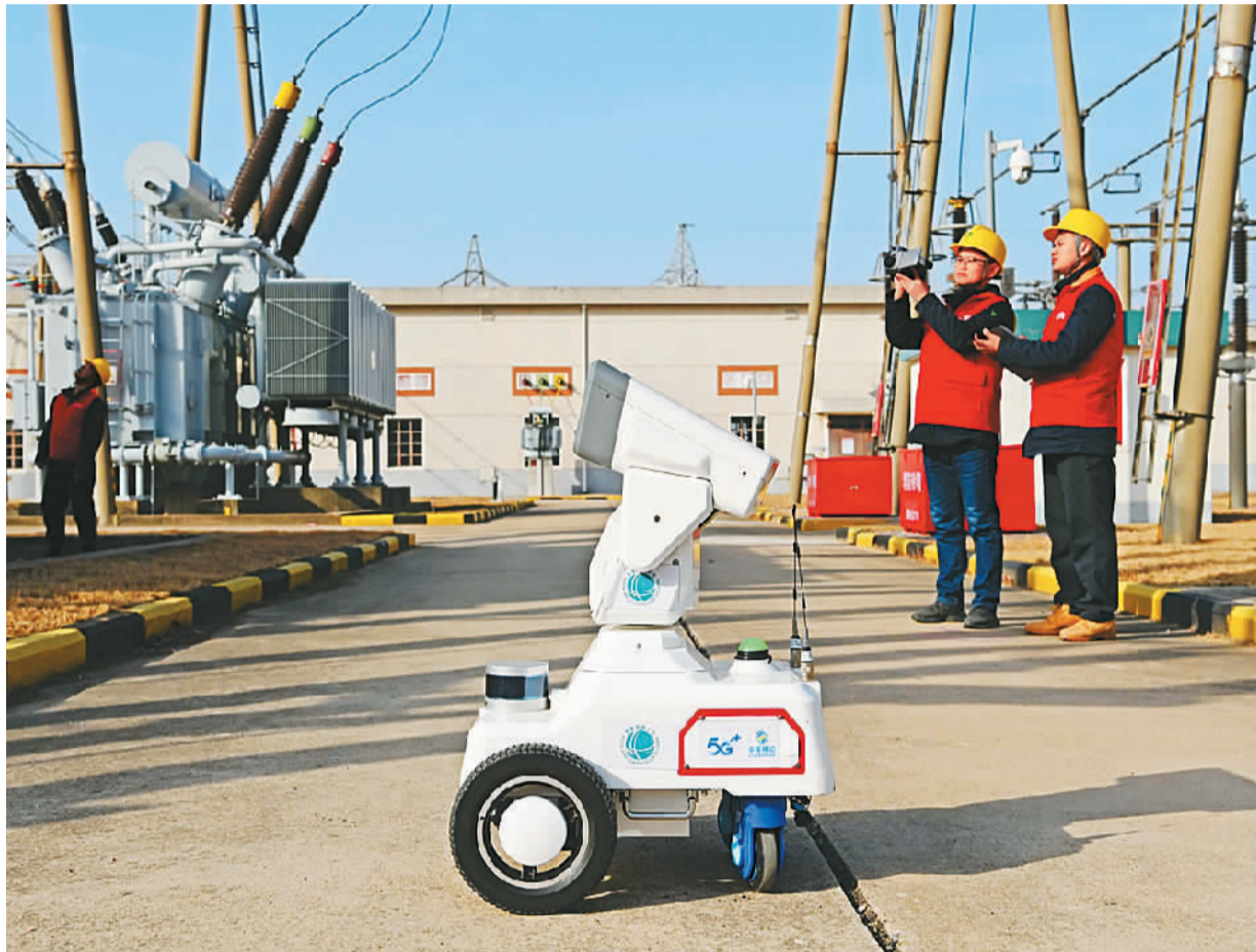
在安徽省滁州市定远县220千伏变电站,一台5G智能机器人和运维人员对变电站内主要供电设备进行巡检。
