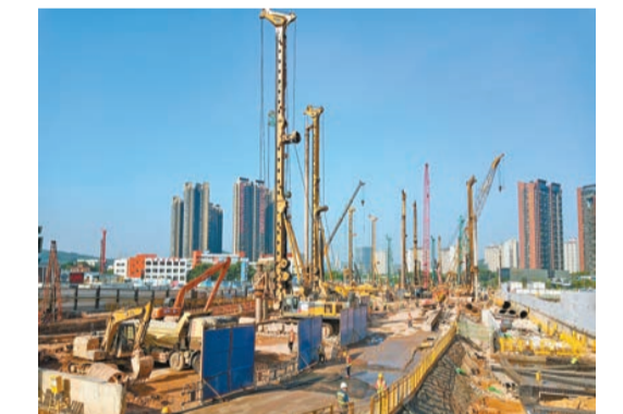
圖為深大城際2標四區大運站圍護結構施工。深鐵集團供圖
