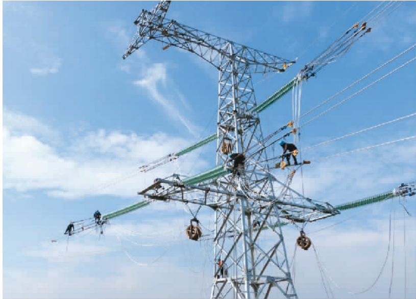
春节前夕，南方电网广东电网公司全力加快500千伏粤港澳大湾区外环西段、东段等重点工程建设，提升大湾区电力供应保障能力。图为在工程建设现场，该公司建设者正在推进导线展放的施工任务。
