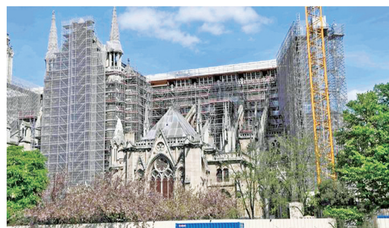
资料图:2022年4月15日是巴黎圣母院大火三周年。巴黎圣母院临时的金属脚手架已经搭建完毕,以保证巴黎圣母院结构稳定。中新社记者 李洋 摄
