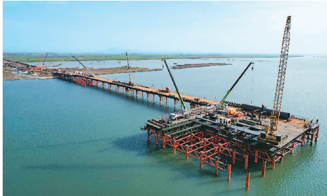
最近，湖北省襄荆高铁重点控制性工程——宜城汉江特大桥的工地上，一片热火朝天的建设景象。目前，全长1.6公里的施工栈桥已建成1.2公里。图为施工现场。郑新涛摄(人民视觉)
