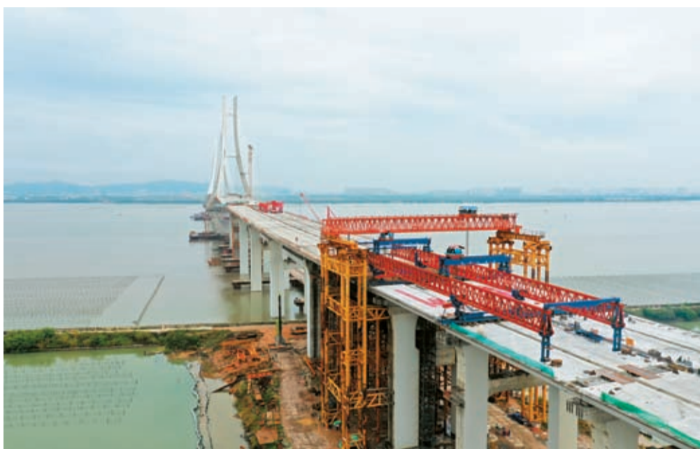
牛田洋特大橋南岸陸上引橋最後一片鋼混組合梁安全就位。
