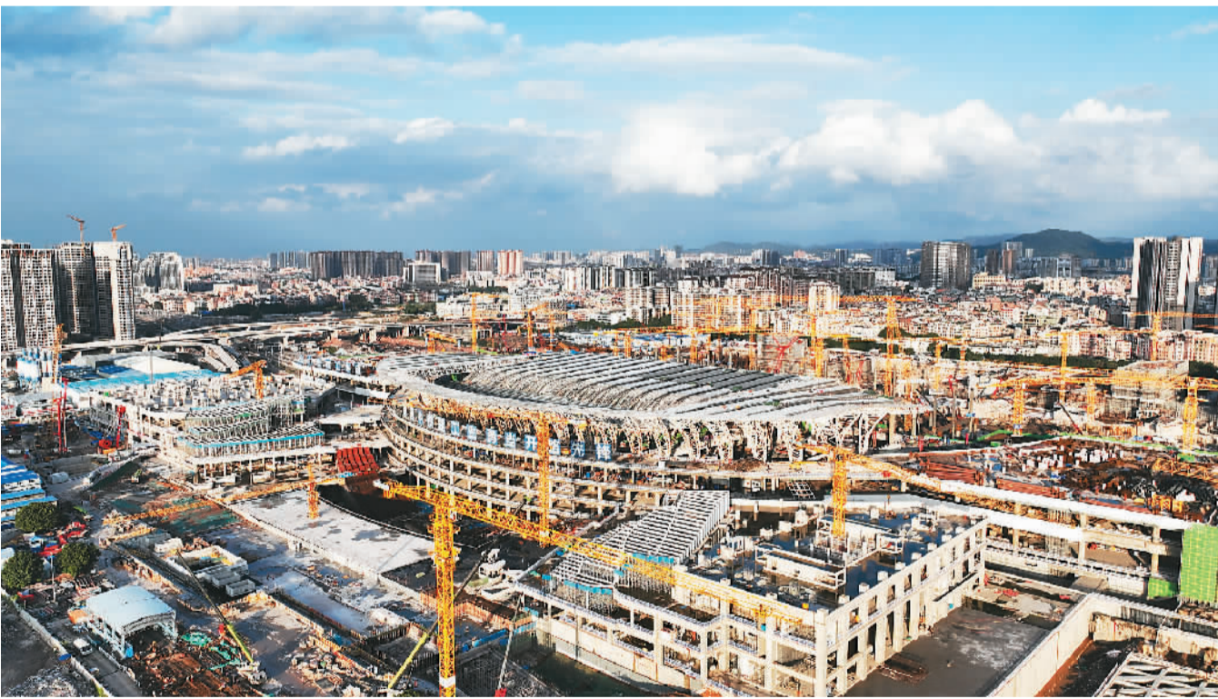
连日来，广东广州白云站建设稳步推进。广州白云站项目位于广州市白云区，是“十三五”铁路规划中的重要项目，也是广州市和粤港澳大湾区的重点工程，对推动形成粤港澳大湾区范围内“轴带支撑、极轴放射”的多层次铁路网络格局，构建和完善“轨道上的大湾区”体系有着重要的意义。图为建设中的广州白云站。王天水摄（人民视觉）
