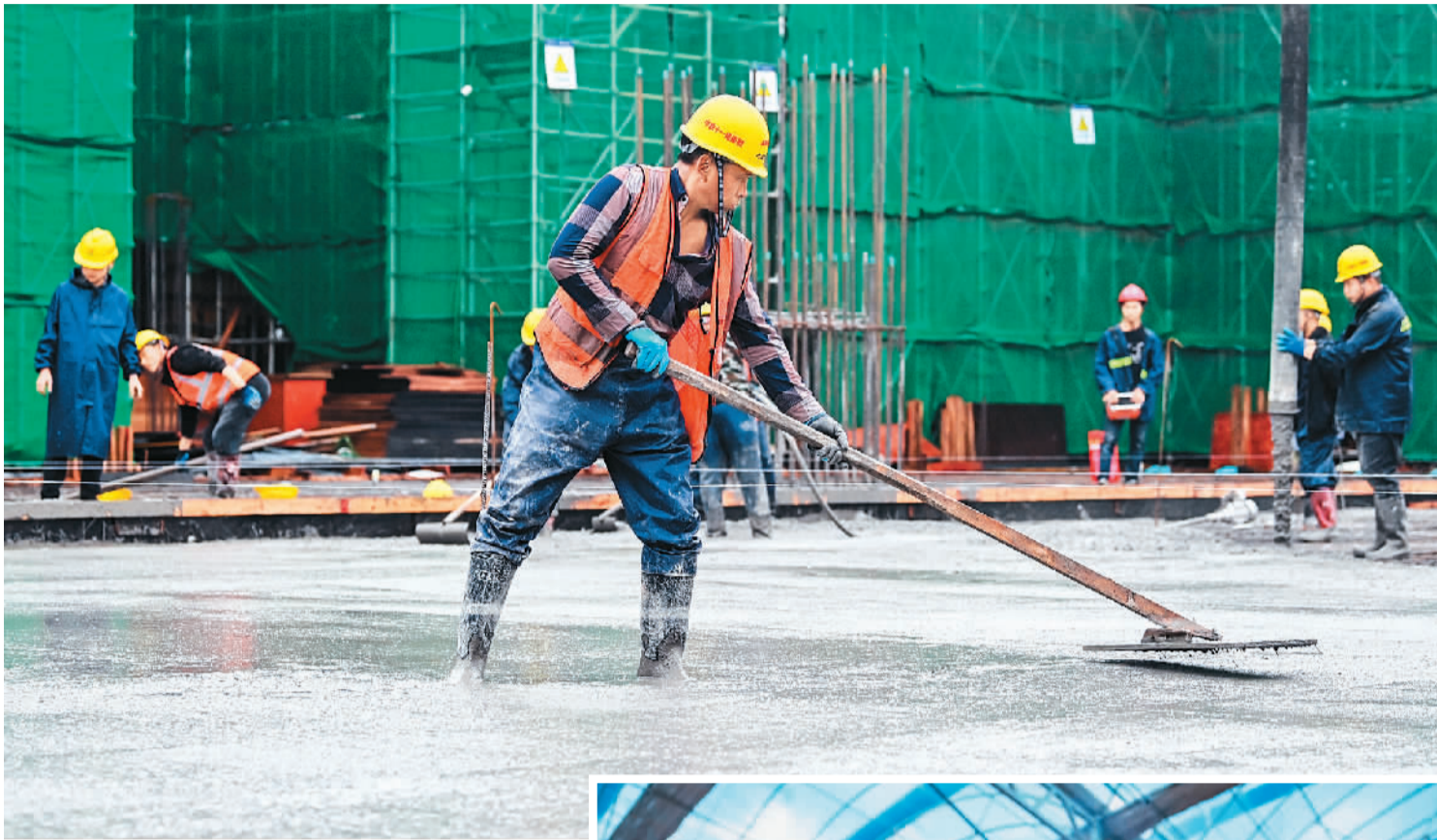
▲在南玉高铁控制性工程玉林北站施工工地，工人将浇筑的混凝土铺平，全力以赴赶工期。
