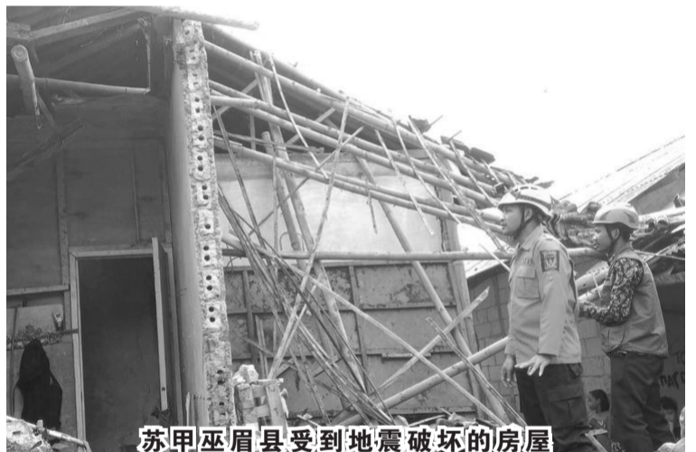
苏甲巫眉县受到地震破坏的房屋
