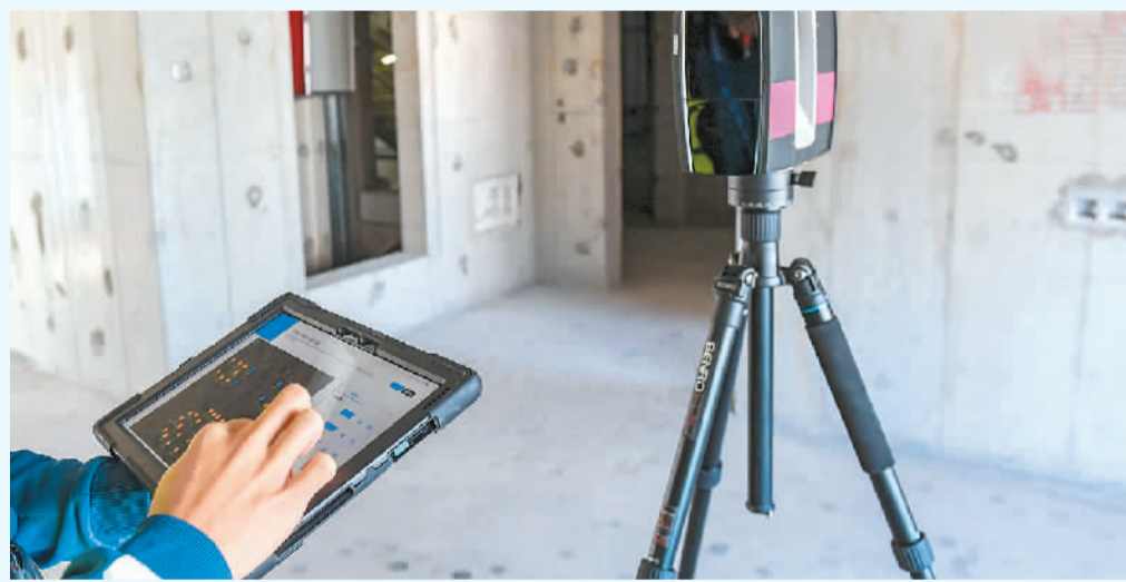
在广东顺德的在建住宅项目凤桐花园，施工人员用平板电脑操控测量机器人对施工房间进行测量。
